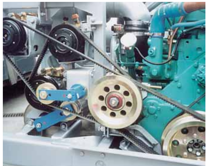
Riemspanner tussen dieselmotor en generator
