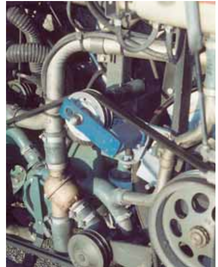
Riemspanner tussen dieselmotor en koudecompressor
